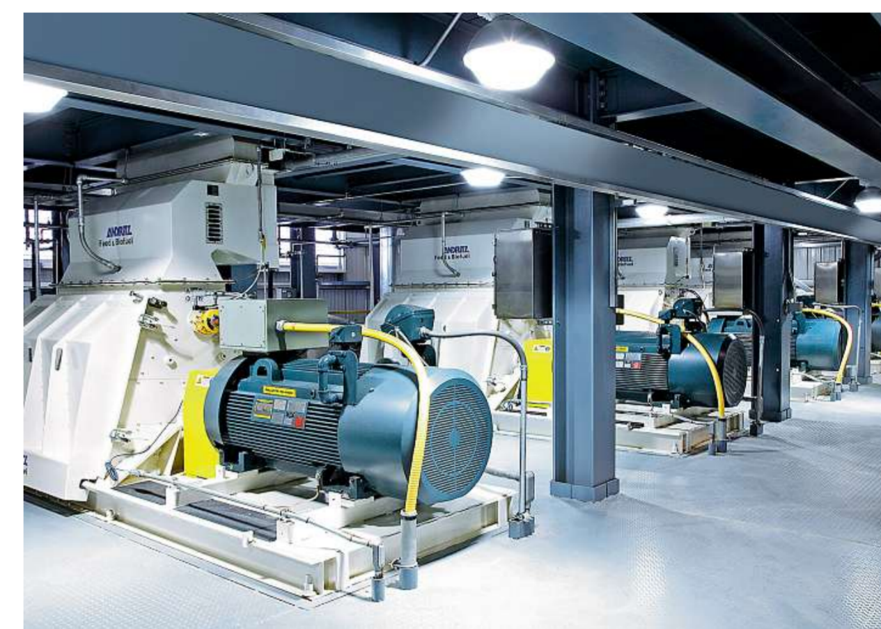
Für die weltweit größte Holzpelletierungsanlage in Waycross lieferte ANDRITZ an RWE Innogy die Prozessausrüstung.
